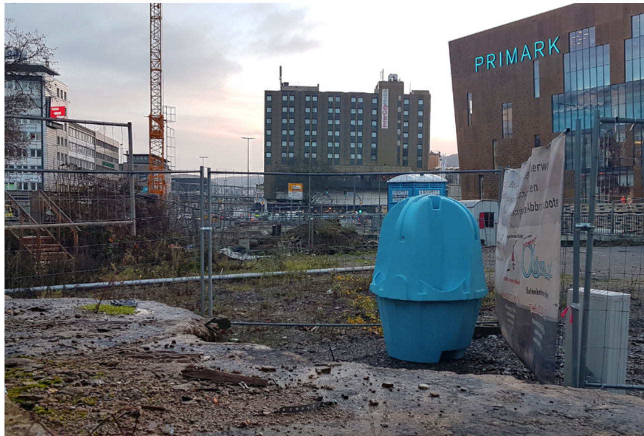
Abbildung 26 ▲ Öffentliches Dixi-Urinal auf dem Baufeld des Wupperpark-Ost
